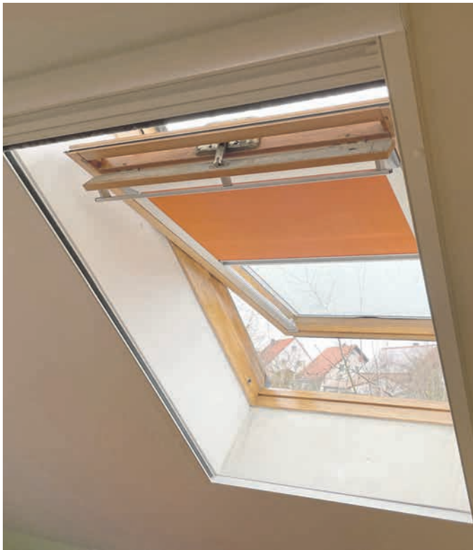
Schimmel entsteht vor allem, wenn feuchtwarmer Luft auf kalte Bauteile trifft. Regelmäßiges Lüften ist daher unerlässlich.
